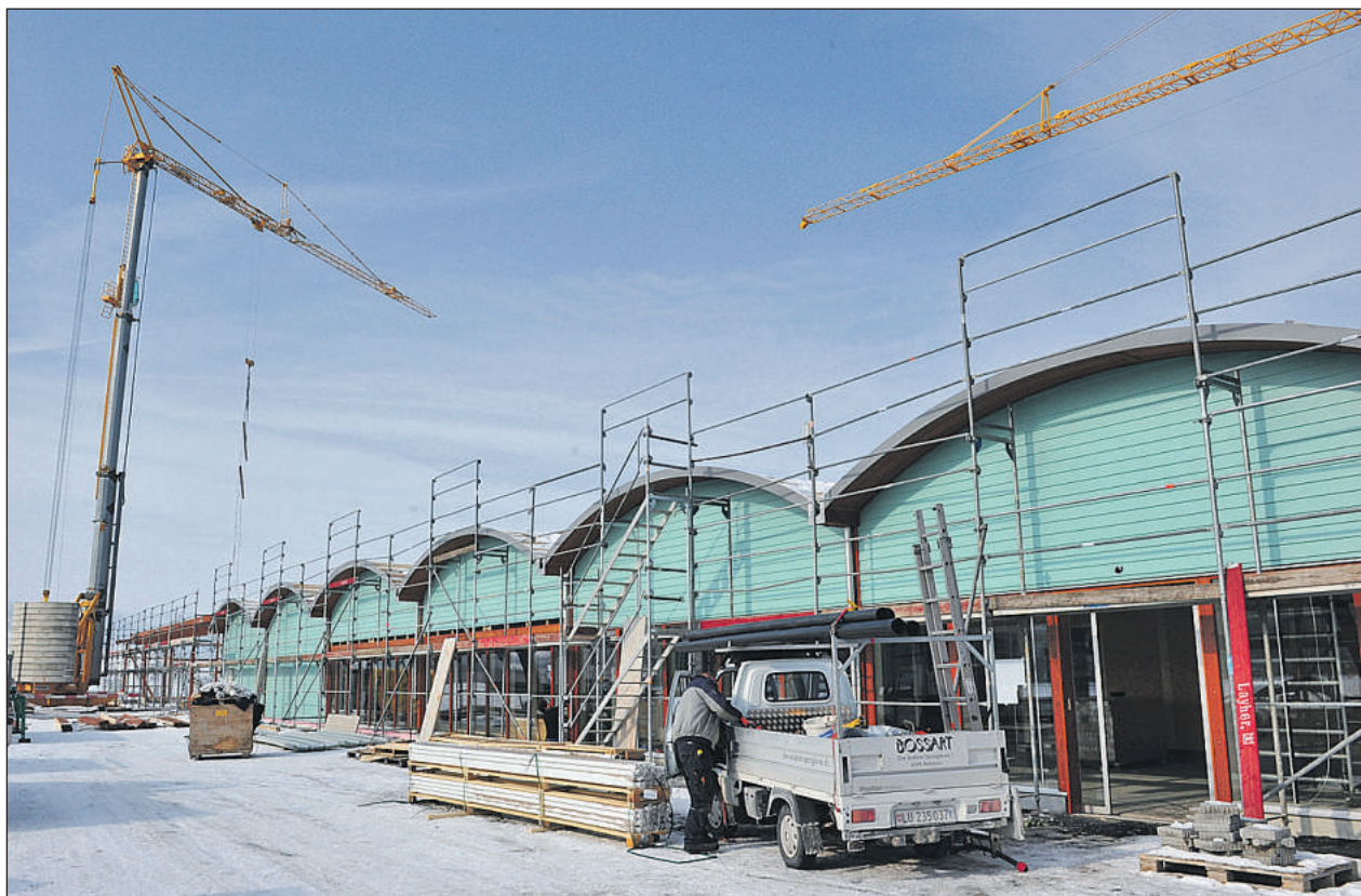
Ein nicht ganz unbekanntes Erscheinungsbild: Der Landi-Neubau im Reinacher Industriegebiet Moos macht deutliche Fortschritte. (Bilder: sas.)
